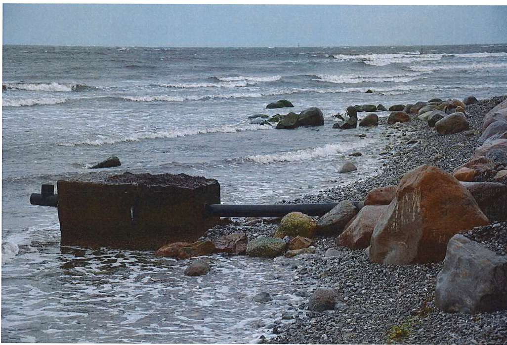
Bild 1. Dagvattenledning vid erosionsdrabbat kustområde i Trelleborg. Foto: SGI
